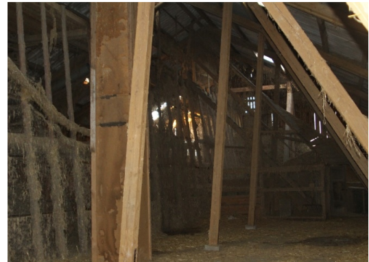
Abb. 17: Heuboden der Scheune, im Hintergrund die vielen Spalten in der Holzverkleidung, welche Zugluft bedingen
