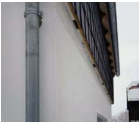
Abb. 26: Spaltenquartiere hinter Schieferverkleidung
