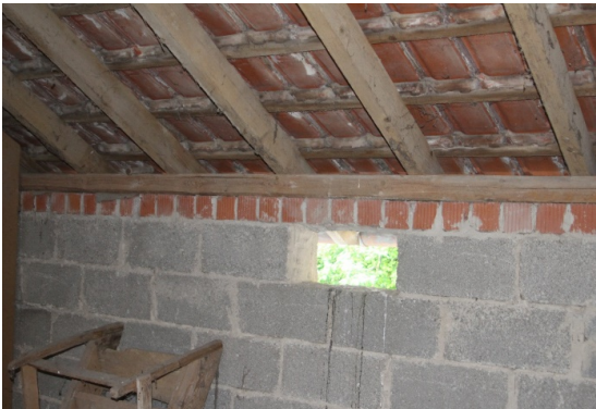
Abb. 16: Einflugöffnung im Dachgeschoss des Schweinestalles, unterhalb der Öffnung ist herablaufender Vogelkot zu sehen
