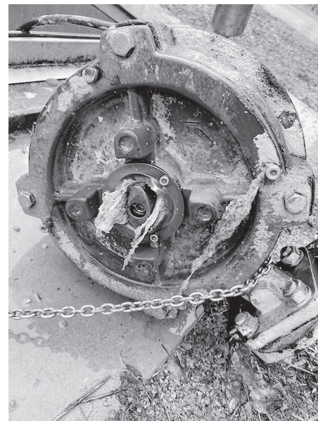
Durch Feuchttücher blockierte und beschädigte Abwasserpumpe aus Erkenbrechtshausen: Falsch entsorgte Hygieneartikel können den Betrieb der Pumpwerke erheblich beeinträchtigen. Foto: Stadtverwaltung
