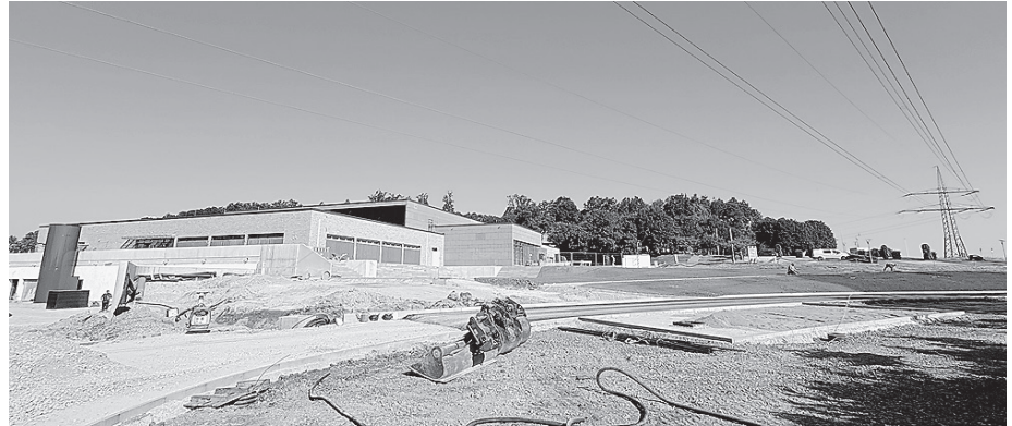
Mit Hochdruck gehen die Arbeiten am neuen Hallenbad in Crailsheim weiter und die Öffnung ist für Ende August geplant. Foto: Stadtwerke
